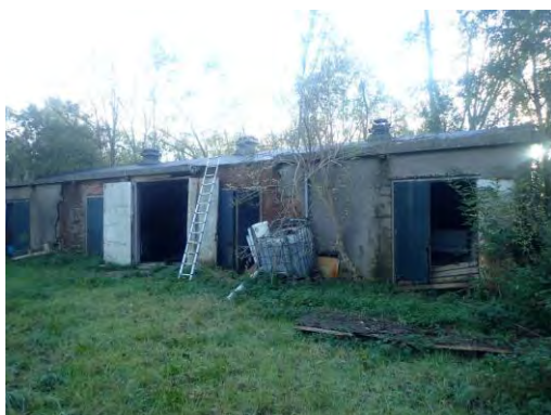
Foto 8: plofhuis A15, dakbedekking bemonsterd als M3 en als asbesthoudend beoordeeld.
