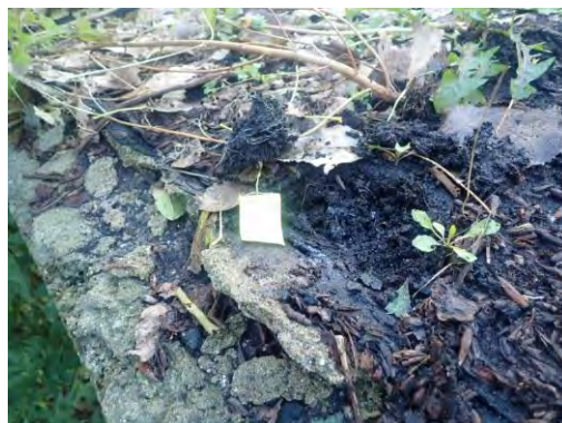
Foto 11: plofhuys A16, dakbedekking bemonsterd als M4 en als asbesthoudend beoordeeld.
