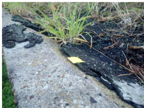
Foto 5: plofhuis A1, dakbedekking bemonsterd als M1 en als asbesthoudend beoordeeld.
