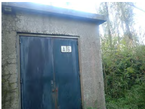
Foto 10: plofhuys A16, dakbedekking bemonsterd als M4 en als asbesthoudend beoordeeld.
