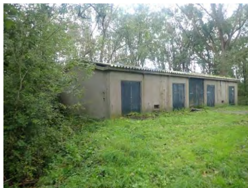
Foto 19: een aantal plofhuizen heeft dusdanig slechte daken dat er een extra dak van metalen profielplaten op is gelegd.
