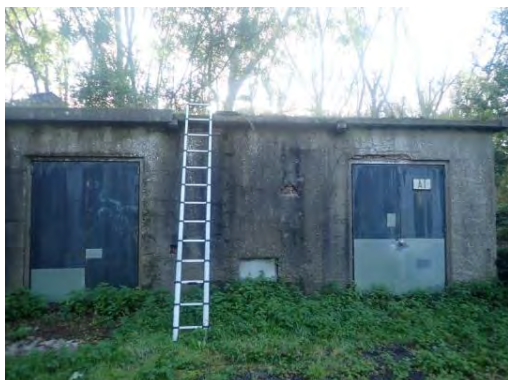
Foto 4: plofhuis A1, dakbedekking bemonsterd als M1 en als asbesthoudend beoordeeld.
