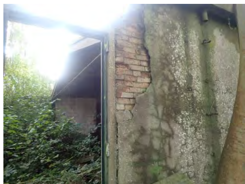
Foto 14: prefab betonnen raamwerken met daarin het stalen deurkozijn verwerkt. Metselwerk gevels afgesmeerd met een dikke laag cementmortel.
