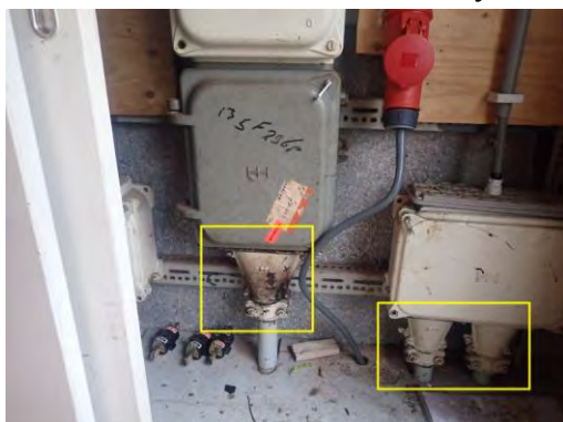
Foto 6: de eindsluitingen tenminste als asbestverdacht beschouwen en mogelijk nog asbesthoudende vlamschotten in de hoofdschakelaar.
