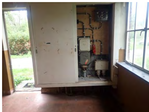
Foto 5: de meterkast in de hal, in deze ruimte een asbest vensterbank en asbest gietvloer.
