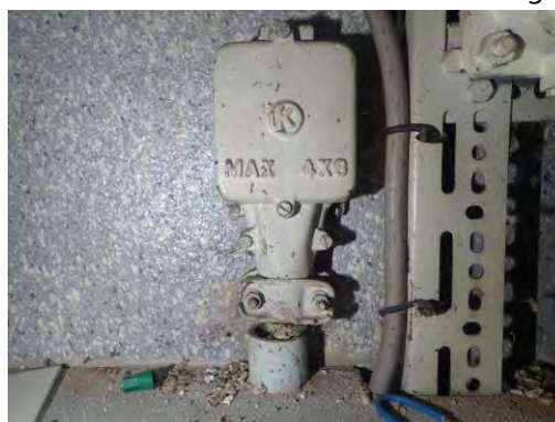
Foto 3: in de meterkast een oude eindsluiting.
